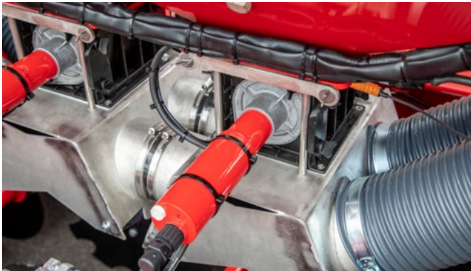
Motor elétrico de dosagem
